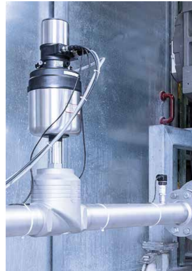
Einsatz des Fluidmengenreglers Typ 8750 in der Förderanlage der Zeppelin Systems GmbH
